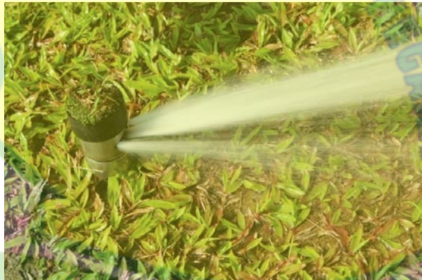
Gambar 3.2: Nozzle bagi sistem penyiraman jenis automatik yang digunakan di Akademi Bola Sepak Negara, Kuantan.
